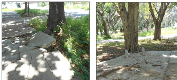
Figura 4. Afectaciones en los pasos peatonales en el parque Palco a causa de las agresivas raíces tabulares
